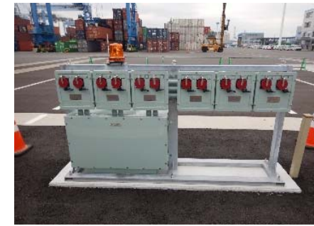
新興津コンテナターミナルに設置されたリーファープラグ
