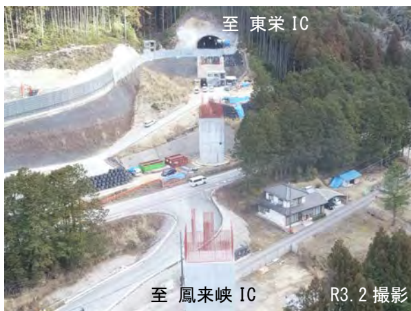
7号橋 橋梁工事の状況 さくま 佐久間道路・ さんえん 三遠道路
