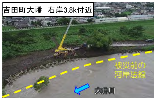
令和2年7月 前線による河岸浸食状況
