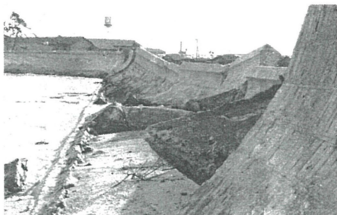
石原地区堤防の決壊 出典：四日市港のあゆみ (昭和62年3月発行)
