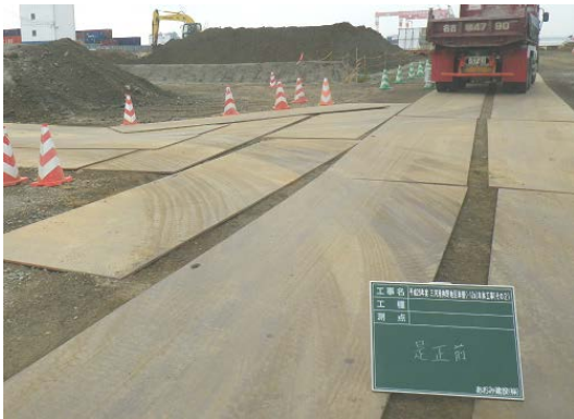
【是正前:作業道路の敷鉄板のぐらつき】
