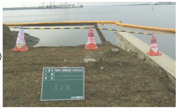
【是正後:バーにより立入禁止の明確化 カラーコーン全てに危険箇所明示】
