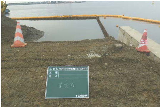
【是正前:立入危険箇所の明示不足】
