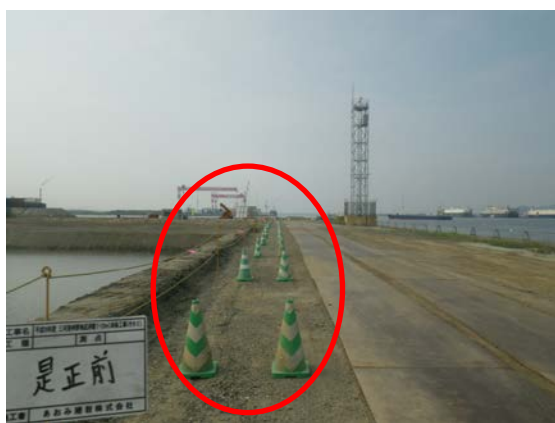
【是正前：歩行者通路の幅が狭い】
