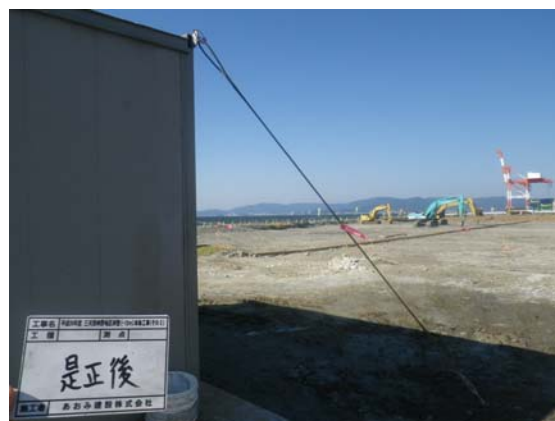
【是正後：ハウスの固定&ワイヤーの明示】
