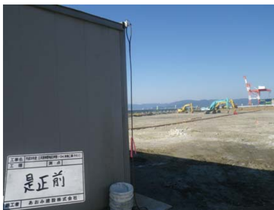
【是正前：ハウスの固定不足】
