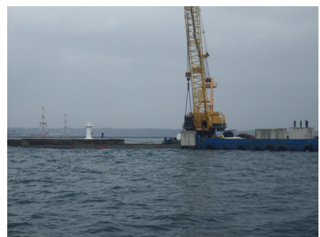
⑥ケーソンの回りに根固ブロックを据付（作業は後日）
